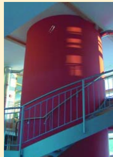
Ein Blickfang ist der Großpufferspeicher.
