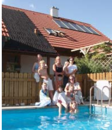
Seit 2001 erwärmt der Schwimmbad-Absorber den Thurmaier-Pool. 2003 ist eine Solaranlage für Dusch- und Trinkwasser hinzugekommen.
